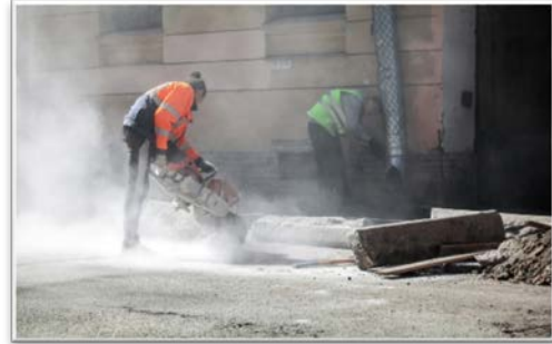
À l'entretien de la voirie : sciage de bordure, tronçonnage des sols et enrobés, balayage...
